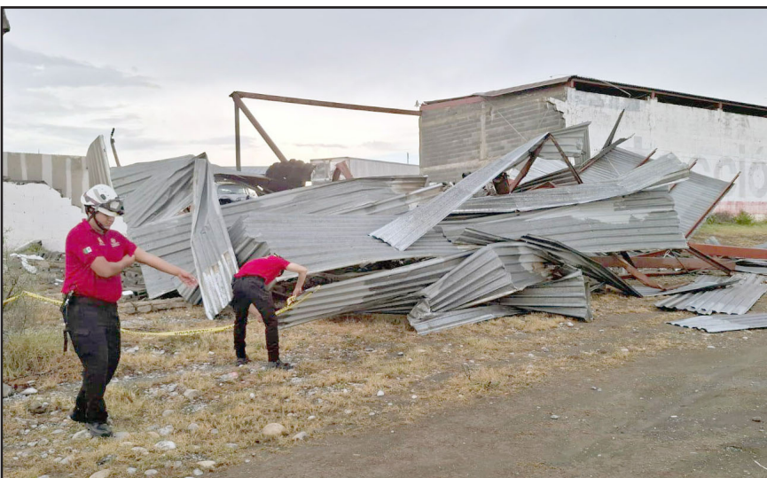
Los fuertes vientos que se registraron en la región causaron daños graves.
