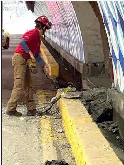
El pasado 18 de septiembre se registró un desprendimiento similar en cinco puntos de la vía.
