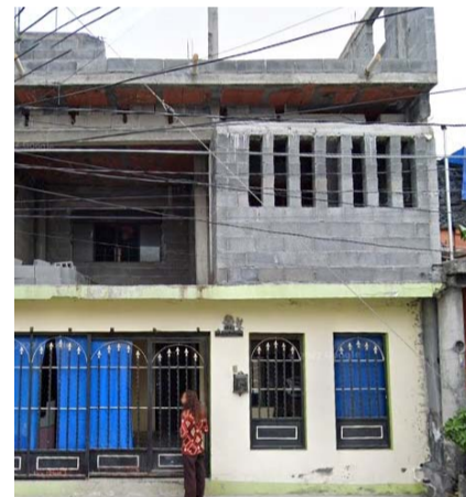
Un hombre perdió la vida al terminar aplastado por varias toneladas de concreto
